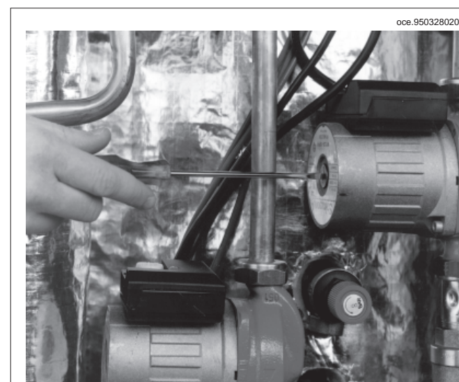
Foto D: Sfiato e sbloccaggio pompa bollitore Foto D: Purgado y desbloqueo bomba acumulador
