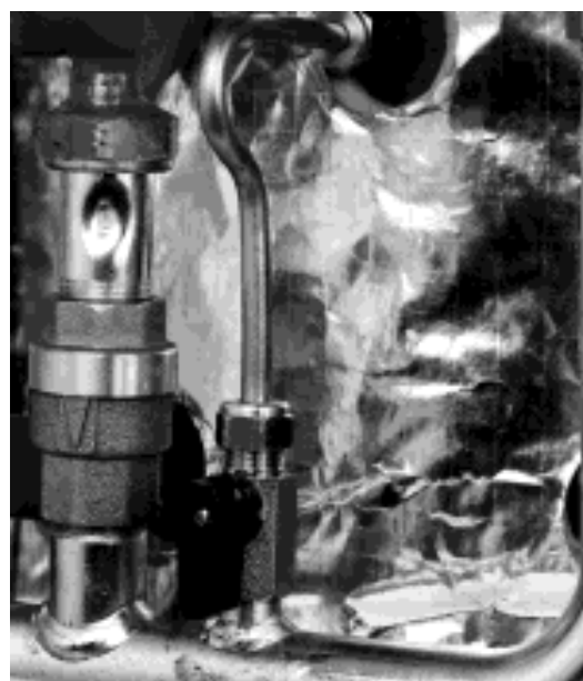
Фото А: Кран заполнения
