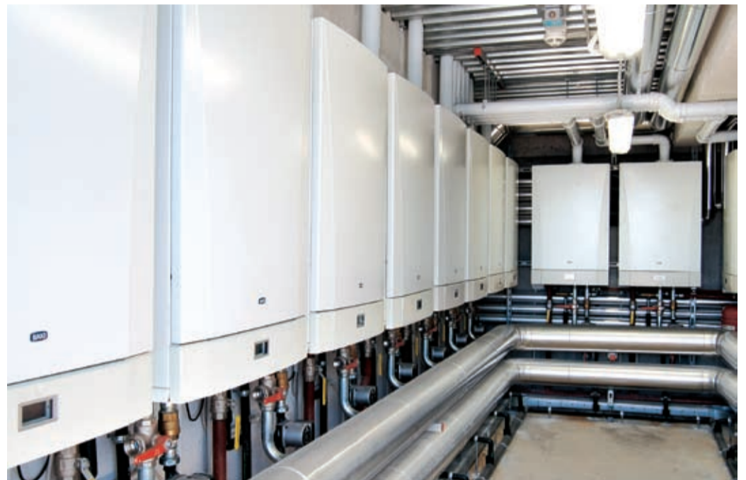
Двадцать котлов LUNA HT Residential, установленных в каскаде
